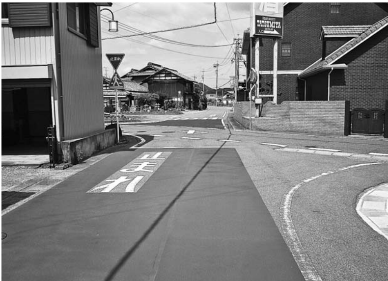
交通事故危険箇所である交差点のカラー舗装
